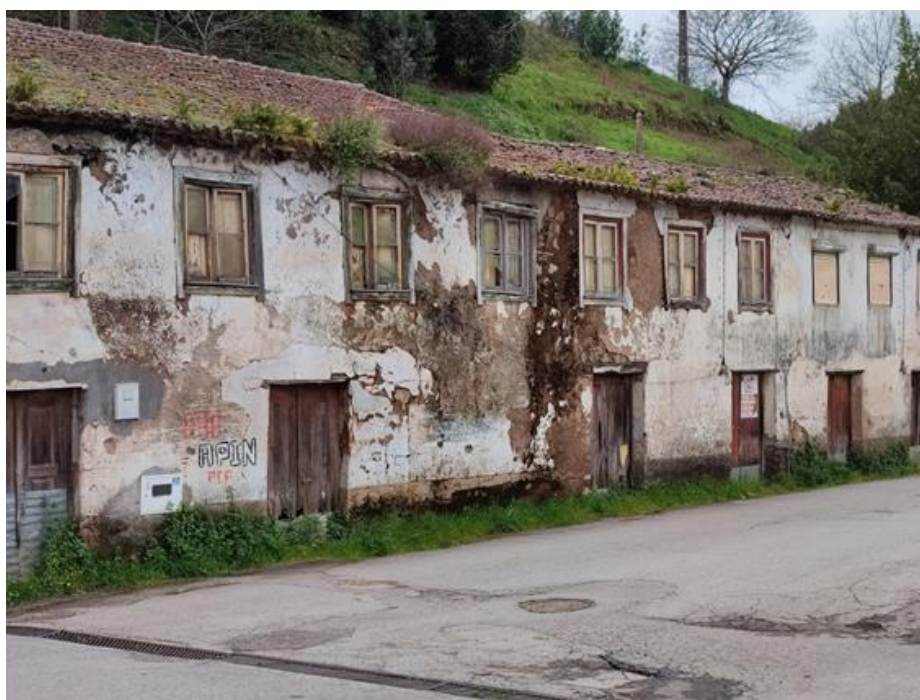
Figura 13 - Imóveis degradados na Ponte de Sótão
